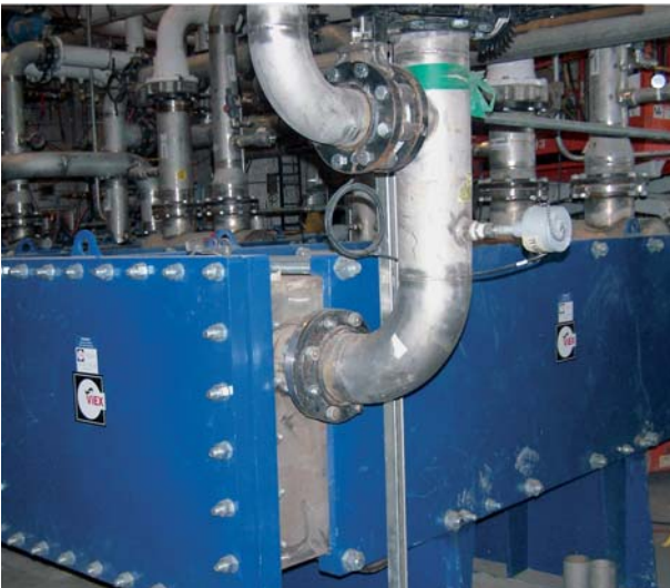
Medición de temperatura con SITRANS T en un refrigerador conectado vía PROFIBUS PA
