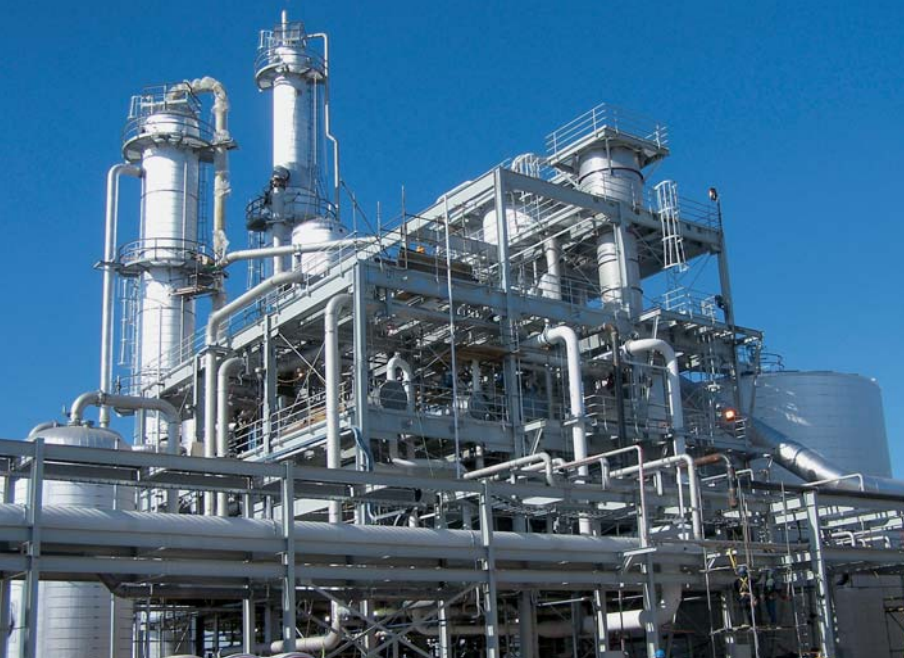
Unidad de proceso de destilación para bioetanol
